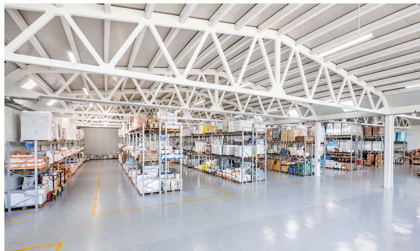
IL CAPANNONE DI MEGA DOLCIARIA È DOTATO DI CELLE FRIGO A 3 TEMPERATURE: - 20, + 4 E + 15 GRADI, REGOLARMENTE MONITORATE
